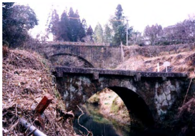
ヤブの中に埋もれていた車橋
